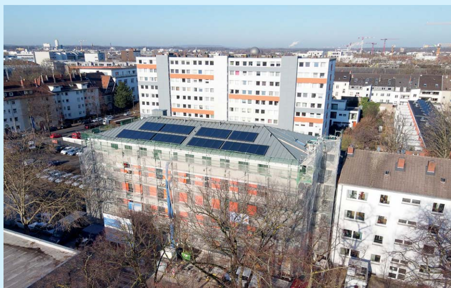
Mit der Kraft der Sonne: An die 75 Prozent des Stroms, den die Photovoltaikanlage auf dem Dach produziert, wird vom Kolping Jugendwohnen Ehrenfeld verwertet.
